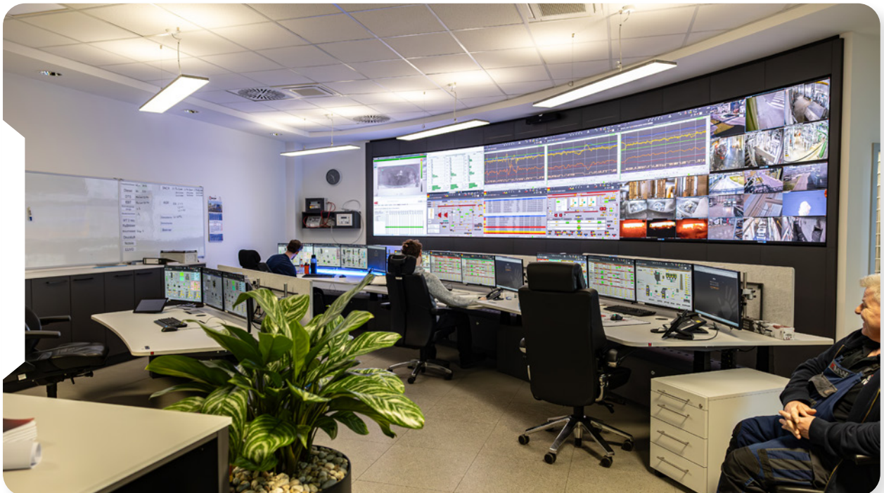
Die neue Leitwarte im Live-Betrieb
