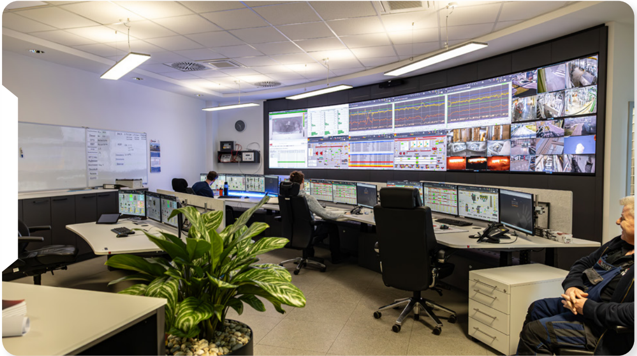
Die neue Leitwarte im Live-Betrieb
